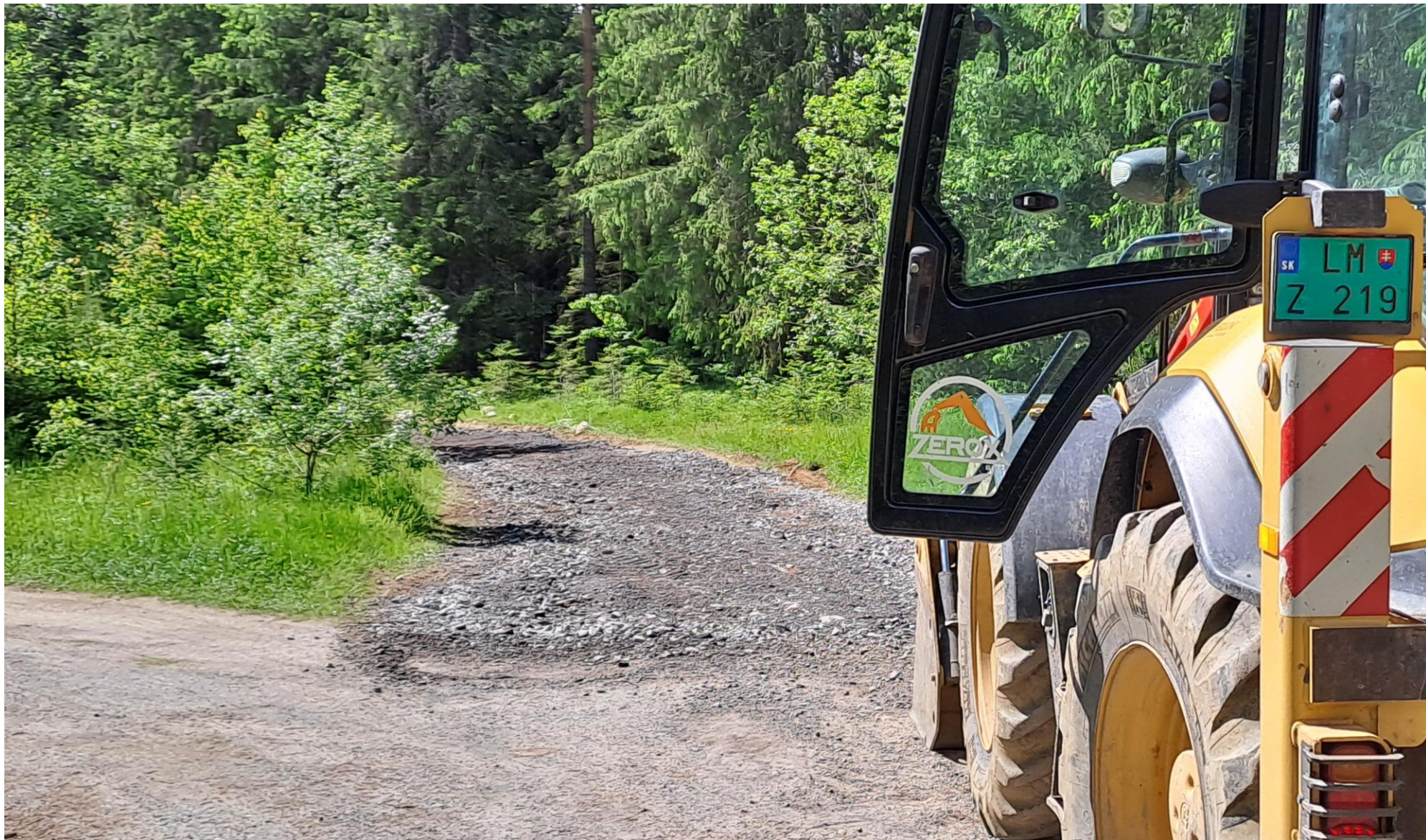
Oprava odvozom dreva poškodenej cesty - Hrdovo
